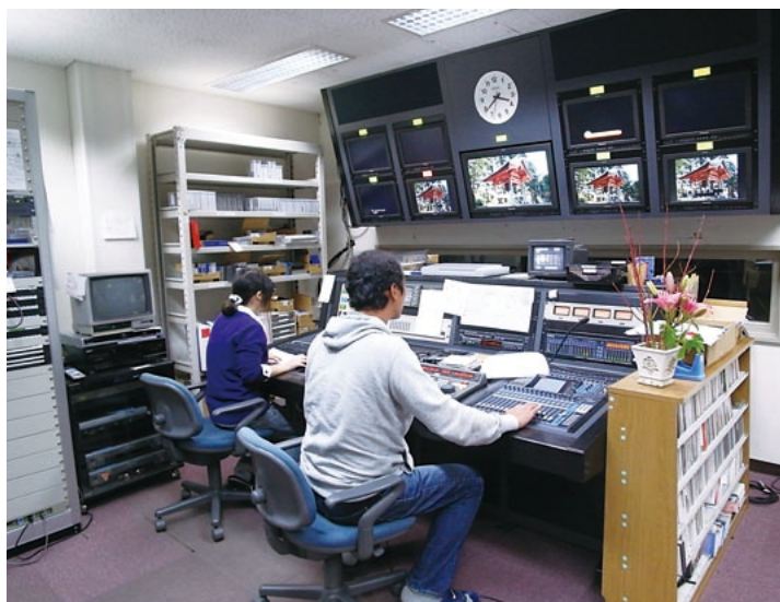
平成21年1月に開局した真庭いきいきテレビ(CATV)の調整室
