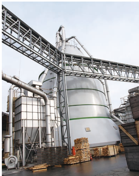
木質バイオマスを燃料とする製材所のエコ発電設備。工場の全電力を賄っている
