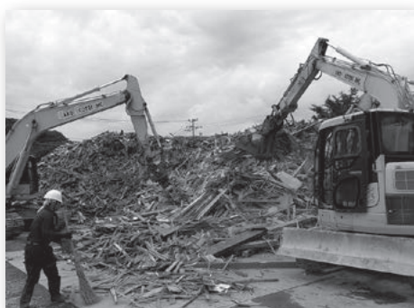
令和元年台風被害(仮置場集積)
