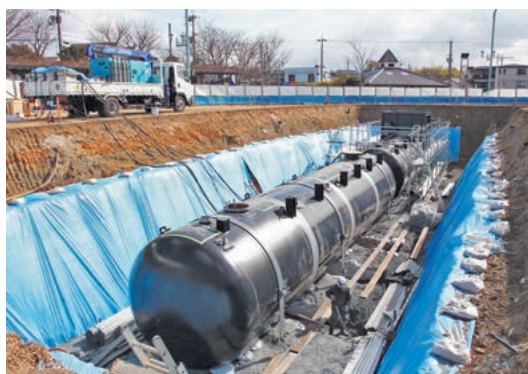
市庁舎近くの公園地下にある飲料水用貯水タンク
