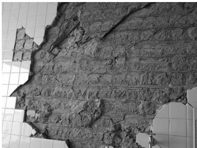
被害を受けた病院建物
