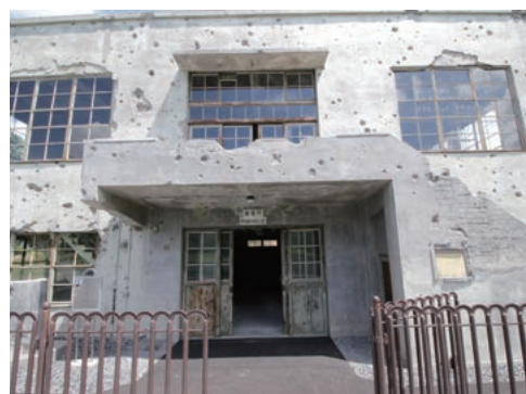
日立航空機変電所の壁に生々しく遺る弾痕
