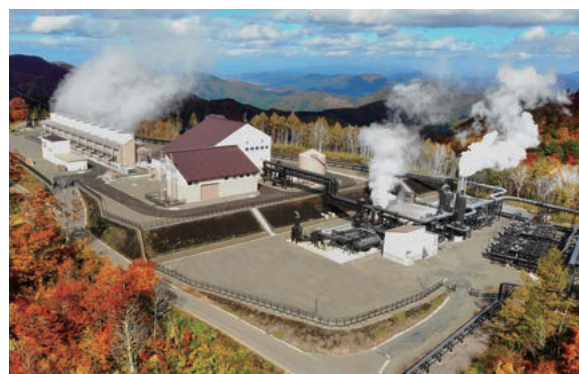
一般家庭約9万世帯分を発電する山葵沢地熱発電所
