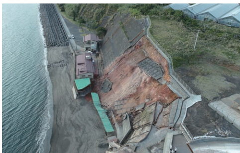
のり面が崩落した砂湯里
