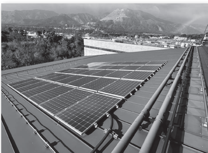
市役所に設置された太陽光発電設備
